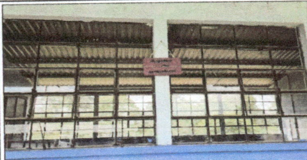
Foto 1: Ventanales los cuales serán sustituidos por balcones, debido a que ya se encuentran deterioradas y no es posible abrirlas por el óxido que han acumulado, además la escuela se encuentra en un área cálida, esto ayudará a que el aire refresque el interior de las aulas.
